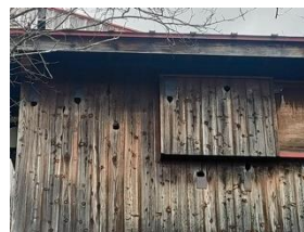
写真1. キツツキが好んでつつく老朽化した板張りの外壁
